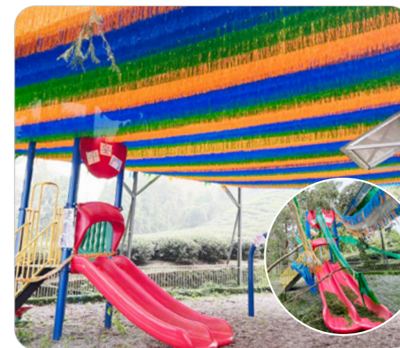
遊戲場的遮陽網，於凱米颱風時遭到風倒木倒落壓損，並於移除風倒木時基於安全考量作部份拆除。
